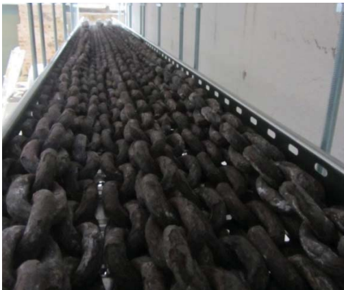
Bild 2: Belegung der Kabelrinnen mit Stahlketten
