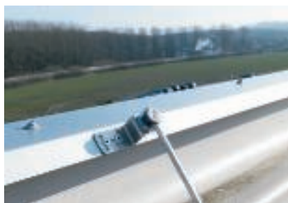
Tilkobling av loftet til lynbeskyttelsessystemet
