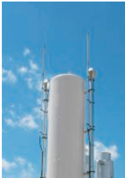
isCon®-system i utblåsningsanlegget på et biogassanlegg
