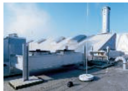
Isolert lynvern på takoppbygg
